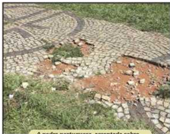
A pedra portuguesa, assentada sobre areia, solta-se com facilidade
