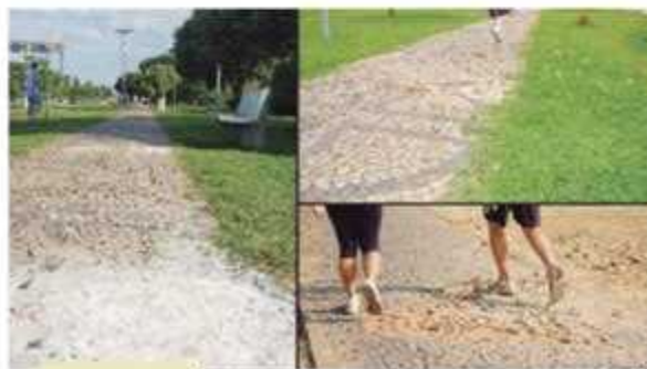
Cheia de buracos, a pista coloca em risco de contusões os praticantes de caminhada
