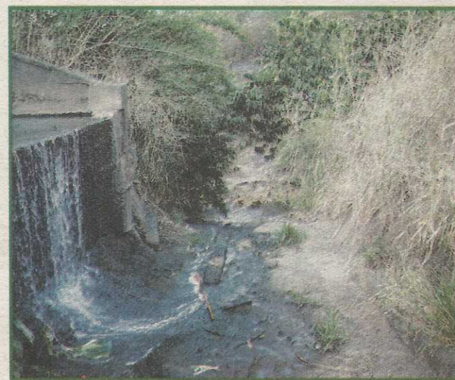
Esgoto jogado no córrego
