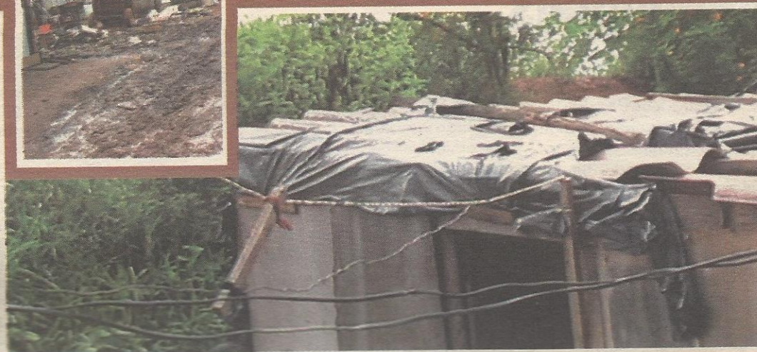
As instalações elétricas são precárias e ao alcance de qualquer pessoa.
