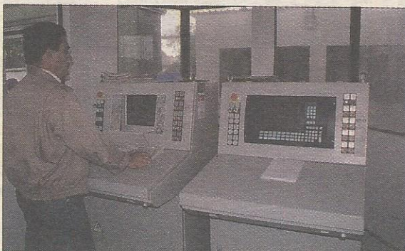
A central de computadores comanda o serviço
