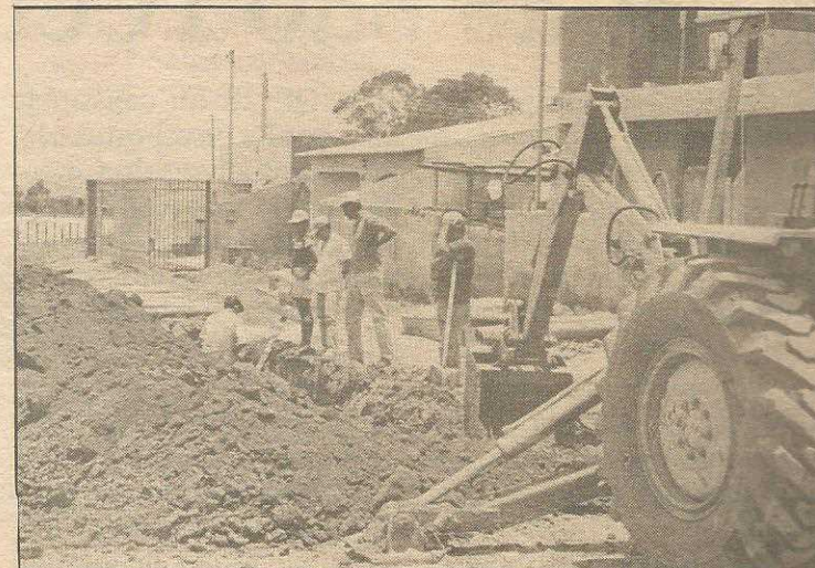
Esgoto chegou às 42 e 44
